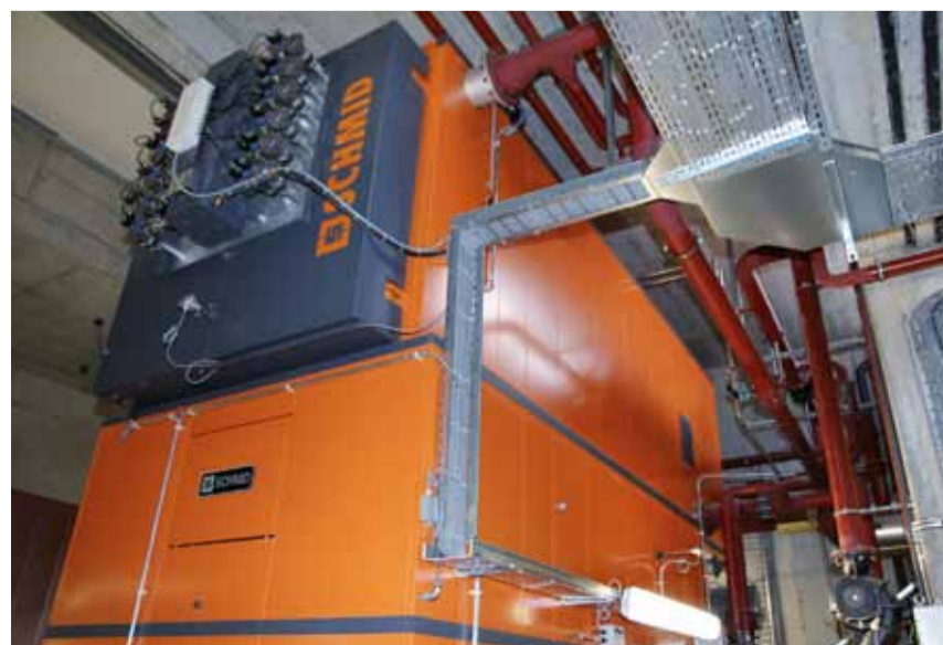
Neuer Heizkessel 2000 kW
