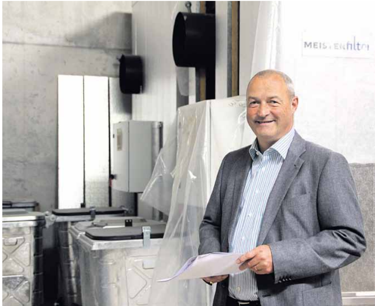
Baukommissionspräsident Lucas Peter vor der neuen Filteranlage in der Heizzentrale des Wärmeverbunds Schlossfeld Willisau AG. Sie erfüllt die neusten technischen Anforderungen. Foto Irene Zemp-Bisang
